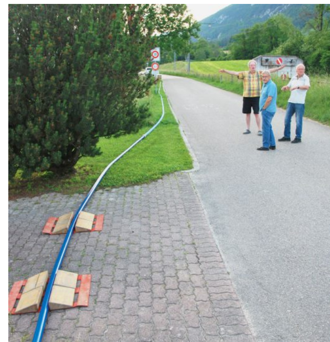
Une conduite provisoire entre Crémînes et Grandval a permis de réalimenter en eau les ménages. Le maire de Grandval, Roger Minder (à droite) supervise l'installation provisoire. LDD
